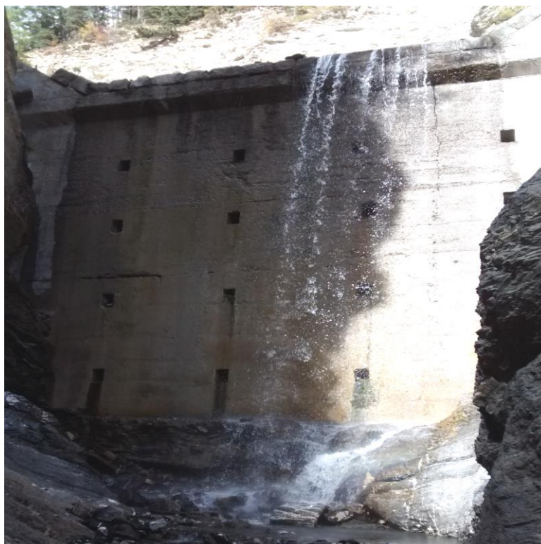
Figure 71. Photographie du barrage B25 – affouillement important en pied
