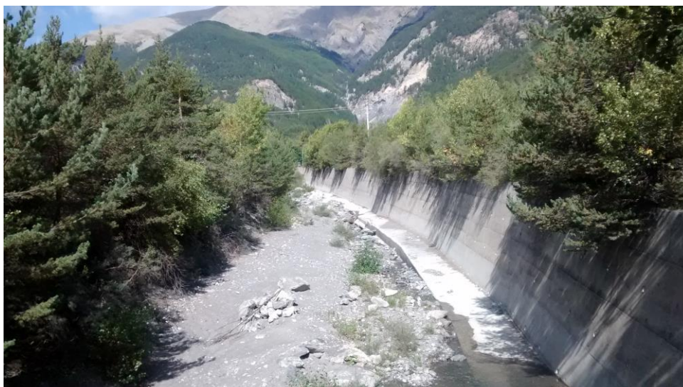
Figure 51. La Rua –Digue rive gauche en béton armé à l’amont du pont de Briançon
