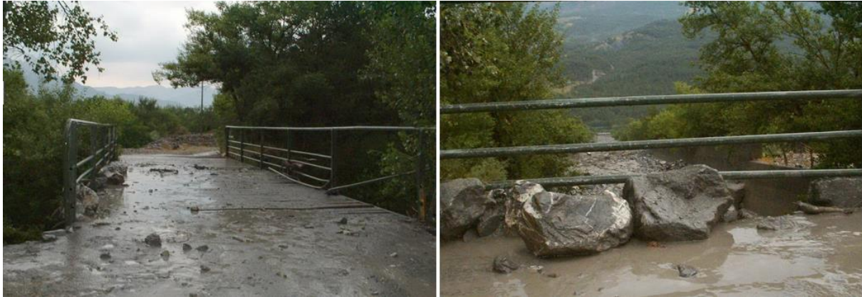
Figure 40. Photos des « débordements sur le pont de Briançon » sur le cône de déjection – crue de 2003
