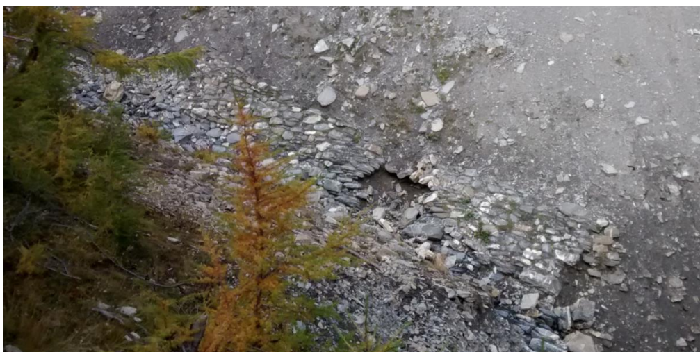
Figure 73. Photographie du barrage et pavage n°1 – pathologie du pavage
