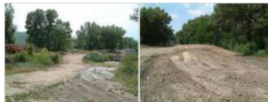
Figure 3-119: A gauche, décharge en avril 2007, et à droite, la décharge pendant les travaux de réhabilitation.
