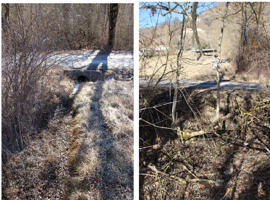
Arrivée du canal côté amont de la route de thon...et côté aval buse totalement bouchée
