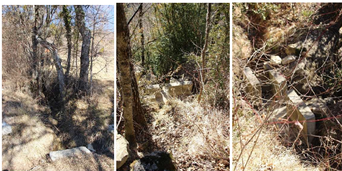
Arrivée du canal en amont du RD 21, puis écoulement jusqu'au canal d'irrigation avec système de vannes
