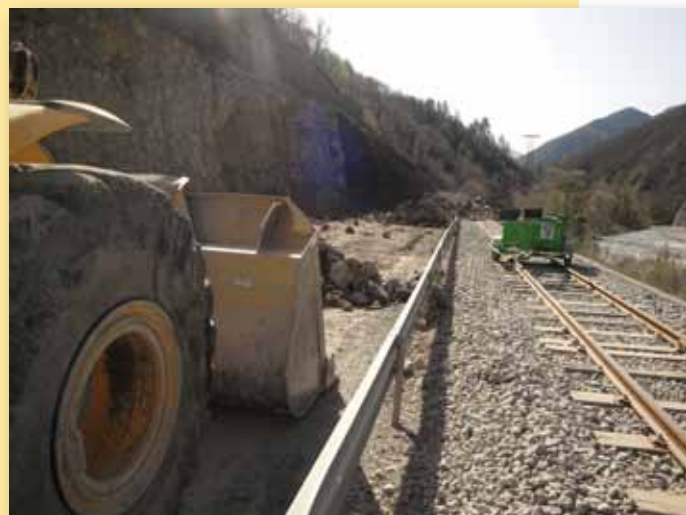
Éboulements sur la RN 85 (Commune de Chaudon-Norante) ▼
