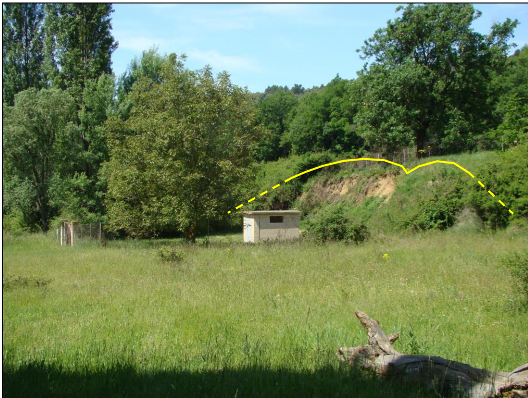
Figure 25 : Talus instable au niveau de la station de pompage [Source : IMS RN ]
