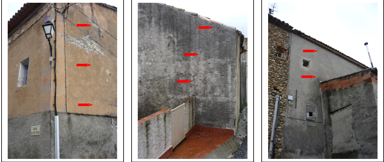
Figure 13 : Fissures sur des maisons [Source : IMS RN ]
