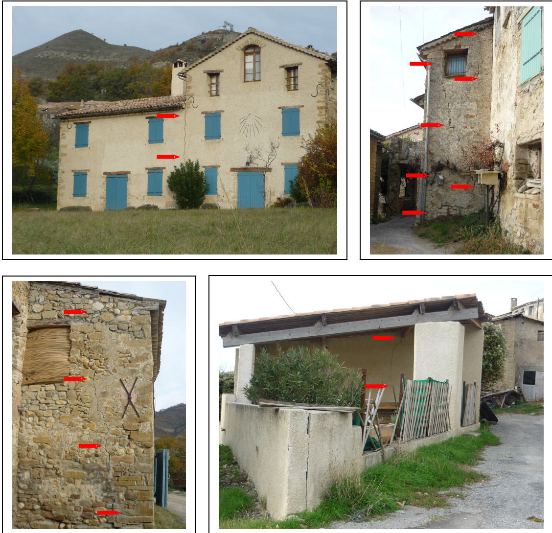
Figure 14 : Fissures sur des maisons (Hameau de la Garce) [Source : IMS RN ]
