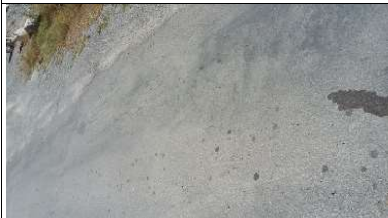
Photo 7 Chaussée Abords Rive gauche Ornière
