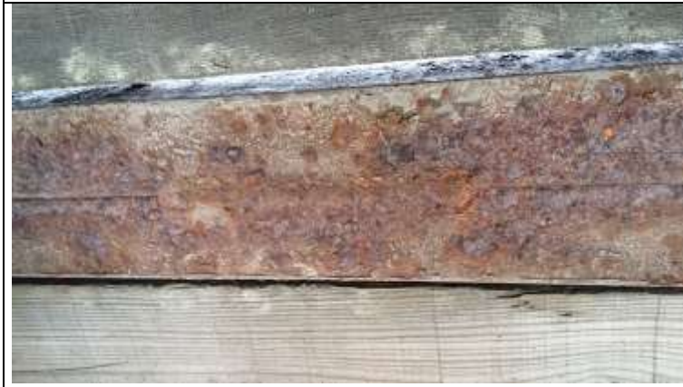
Photo 21 Intrados Pièce de pont Corrosion des soudures avec perte de section
