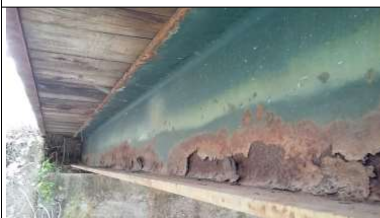
Photo 27 Intrados Poutre Amont Pas de déformation du profil en long Corrosion de la poutre Défaut de protection anti corrosion
