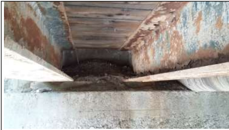
Photo 20 Poutre Ecaillage de la protection anticorrosion Oxydation de la poutre sans perte de section Désordre généralisé Dépôt sur le sommier
