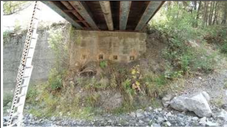
Photo 29 Culée Rive droite Début d'affouillement Affaissement du talus en amont
