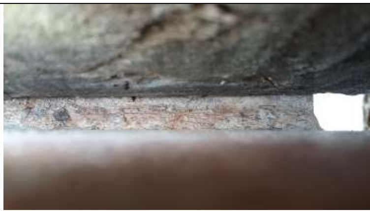
Photo 32 Extrados Soudure pièce de pont sur semelle supérieure de poutre Corrosion de la soudure
