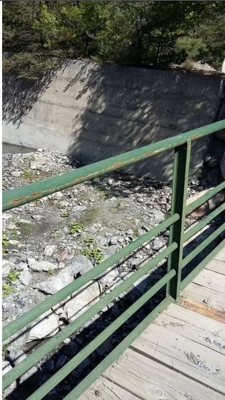
Photo 16 Garde-corps amont Défaut généralisé de la protection anti corrosion
