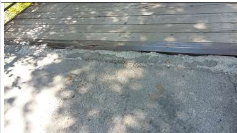
Photo 8 Extrados Rive gauche Protection de pièce de pont déformée
