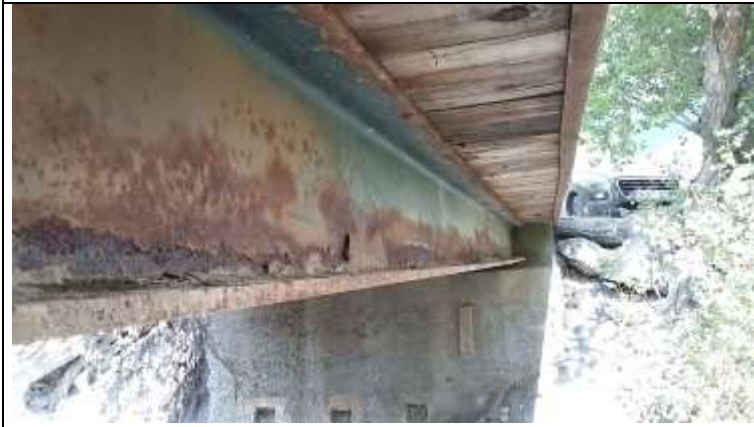
Photo 26 Intrados Poutre aval Pas de déformation du profil en long Corrosion de la poutre Défaut de protection anti corrosion
