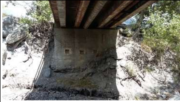
Photo 30 Culée rive gauche Affouillement sous la moitié de la culée Affouillement en pied dans le lit du torrent Effondrement du talus aux abords amont et aval
