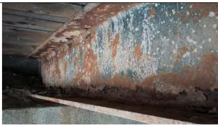
Photo 17 Poutre Ecaillage de la protection anticorrosion Oxydation de la poutre sans perte de section Désordre généralisé
