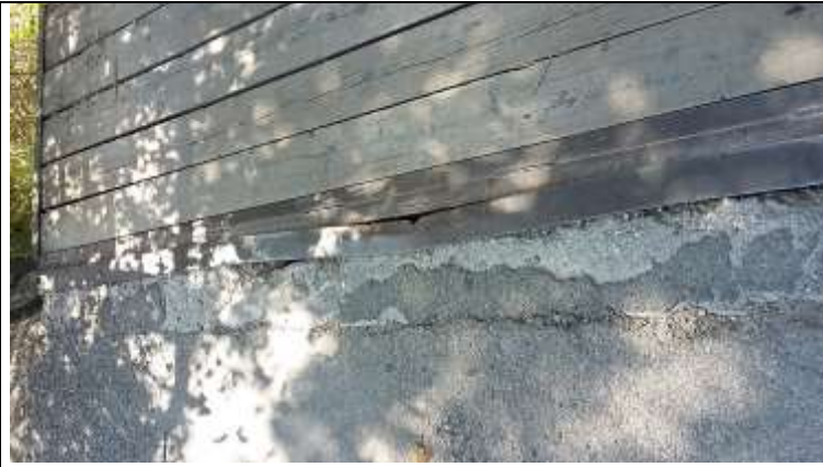
Photo 9 Extrados Rive gauche Protection de pièce de pont déformée
