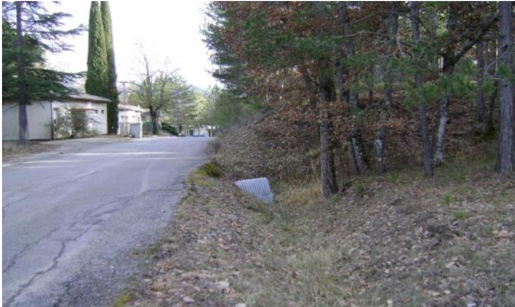
Illustration 18 : Photo de la buse passant sous la route permettant l'écoulement des eaux vers le ravin secondaire (source : Etude sol Concept, 2021)
