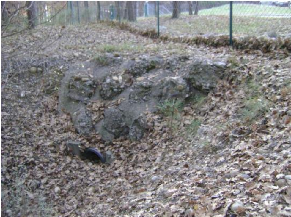
Illustration 19 : Photo de la buse de rejet des eaux pluviales de la M.A.S. dans le fossé secondaire (source : Etude sol Concept, 2021)
