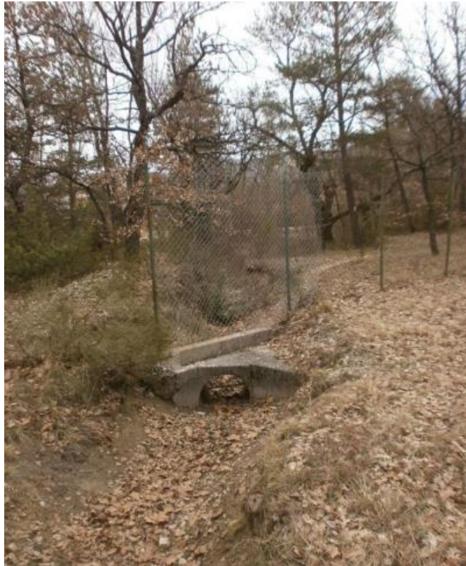
Illustration 22 : Photo d'une buse au niveau au sud-est de la clôture d'enceinte du site du Centre Hospitalier vers le ravin St-Martin (source : Etude sol Concept, 2021)
