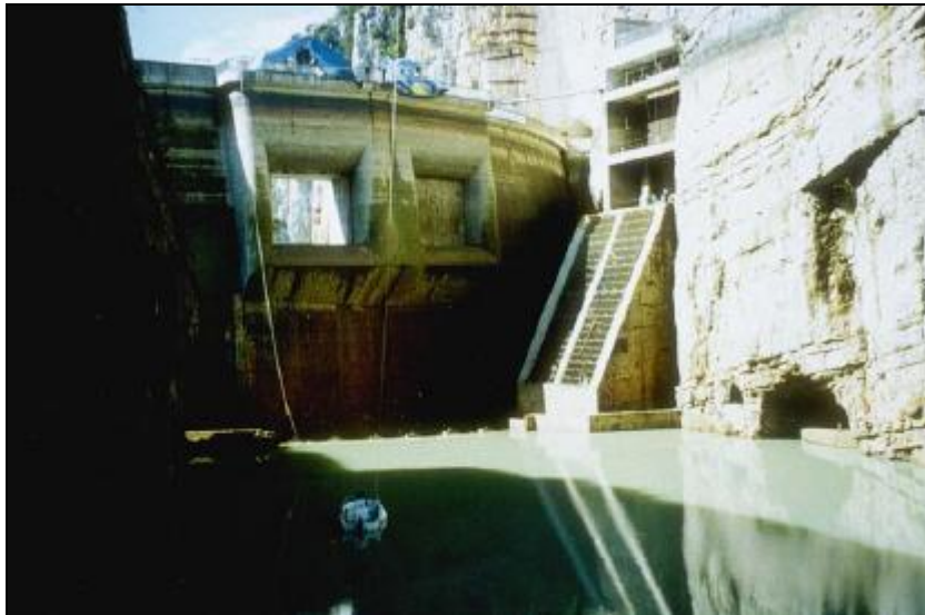
Figure 42 : Barrage de Quinson entièrement vidangé lors de sa visite décennale en 2008 [Source : EDF]
