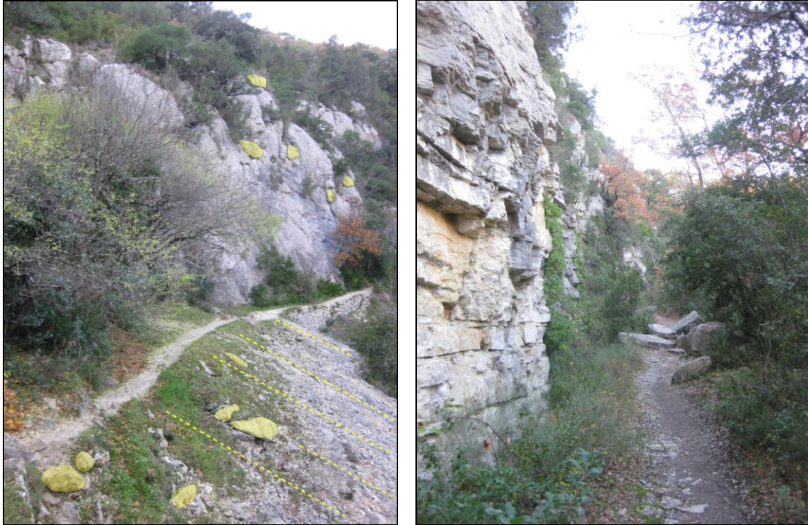
Figure 22 : Escarpements, tabliers d'éboulis et blocs éboulés sur le sentier des Basses Gorges du Verdon [Source : IMS RN ]
