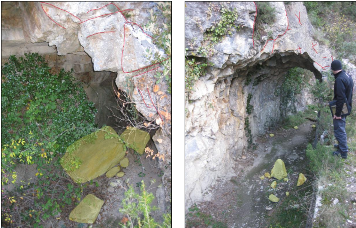
Figure 20 : Tunnels avec voûte fracturée et blocs éboulés [Source : IMS RN ]
