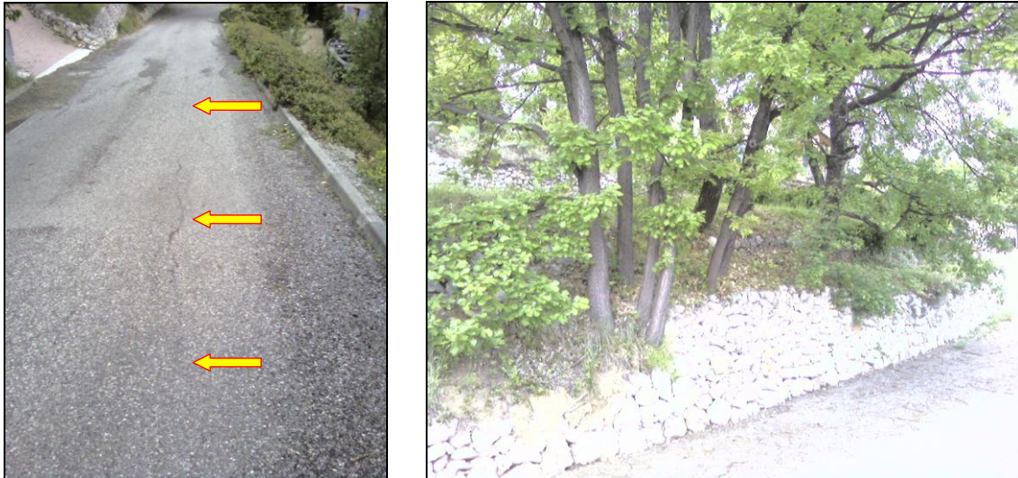
Figure 32 : Chaussée fissurée et arbres tordus dans le secteur de Super Quinson [Source : IMS RN ]
