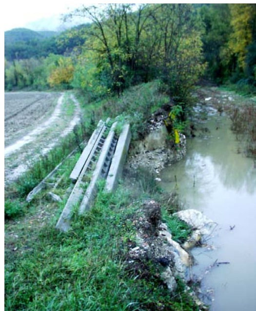
Un exemple d'affouillement de berge par la Laye, en aléa fort (photo Géolithe 2004)
