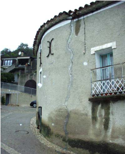
Un bâtiment fissuré par les retraits/gonflements dans le vieux village, en aléa moyen (photo Géolithe 2004)
