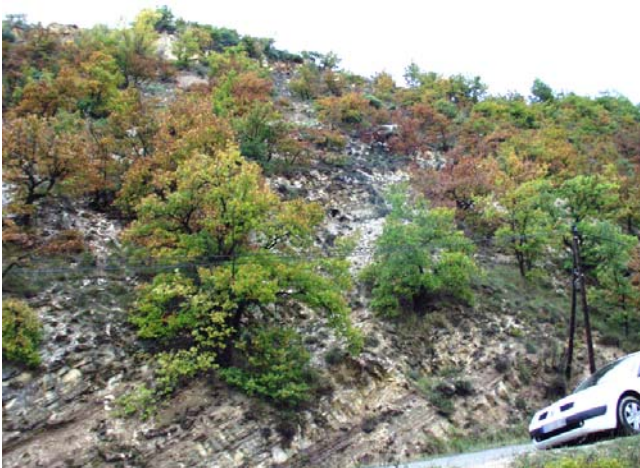
Les affleurements au-dessus de la D513 peuvent générer des chutes fréquentes de petit volume, soit un aléa moyen (photo Géolithe 2004)
