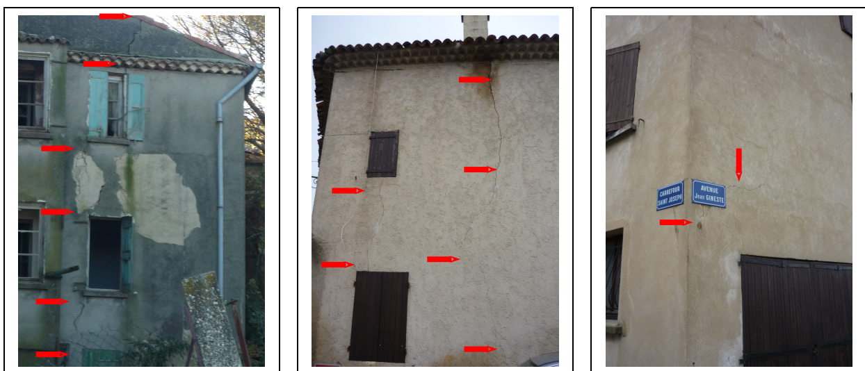
Figure 13 : Fissures sur des maisons (village) [Source : IMS RN ]
