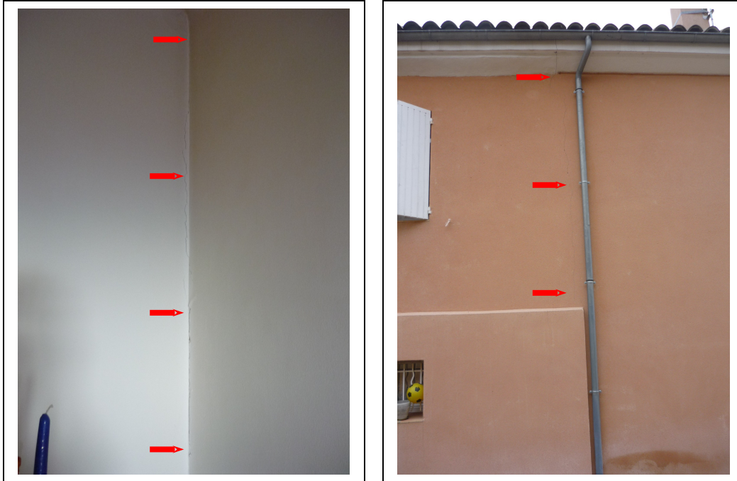
Figure 16 : Fissures sur une maison d'habitation à Belhonneur [Source : IMS RN ]
