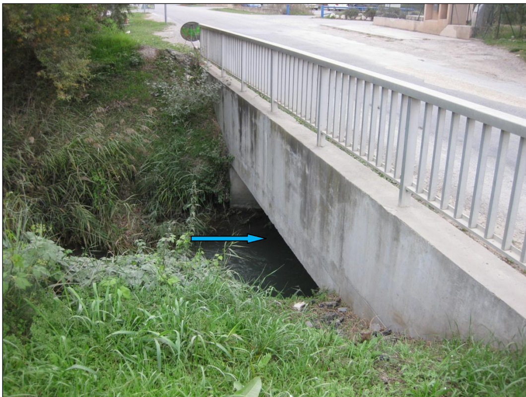
Figure 56 : Torrent de Drouyes au niveau de la zone industrielle Saint-Maurice [Source : IMS RN ]
