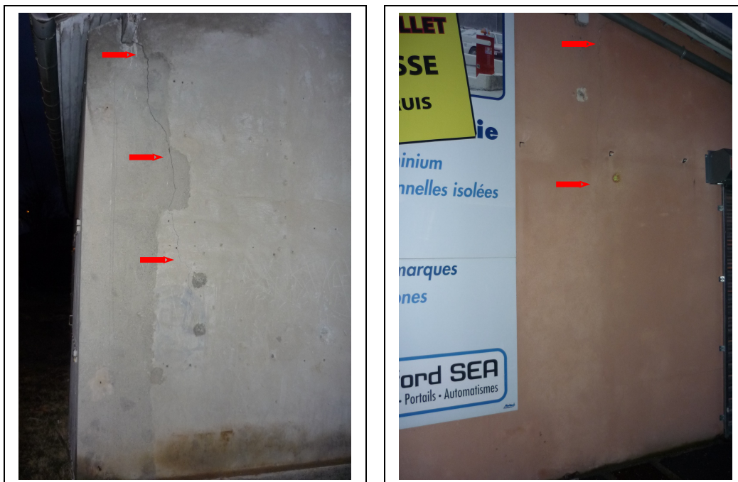
Figure 12 : Fissures sur des constructions (Avenue de Haute-Provence, à l'est de la ville) [Source : IMS RN ]
