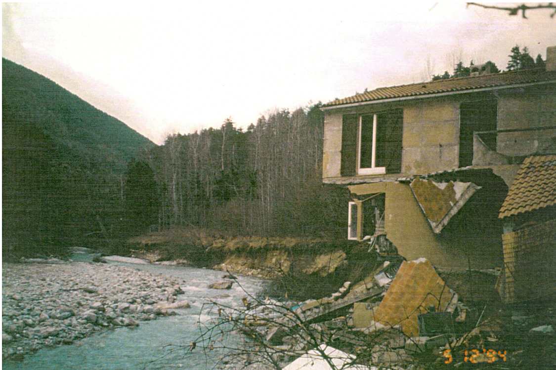
Crue de la Vaire du 5 Novembre 1994 Affouillements et destruction de la maison de Mr CAMERA
