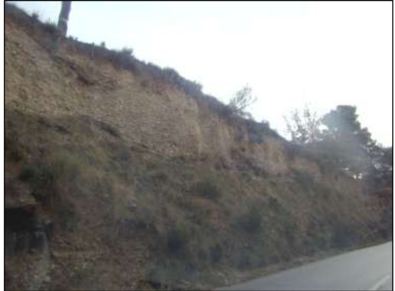
Figure 60 : Talus générant des chutes de pierres en bordure de la RD 6 [Source : IMS RN ]
