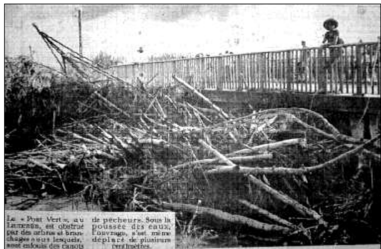
Figure 15 : Embâcle au niveau du Pont-Vert au Lamentin, Guadeloupe (en novembre 1966) [Source : France-Antilles]
