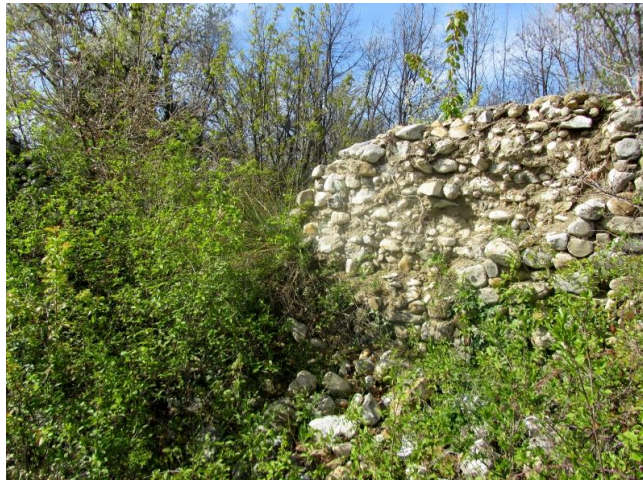
Illustration 12 : Brèche en rive gauche du Champlong.
