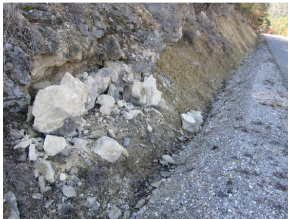
Illustration 39 : Chutes de pierres/blocs au niveau de la D17 (source = RTM04)
