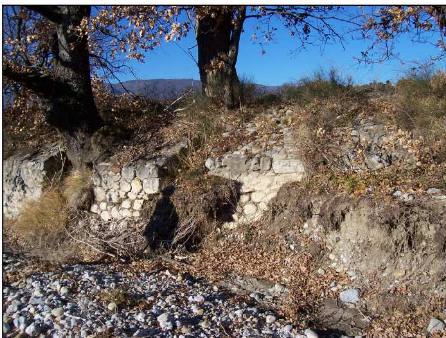
Photo 8: Le Vançon –Ouvrages, anciens, de protection de la berge rive droite en amont de la RD4.
