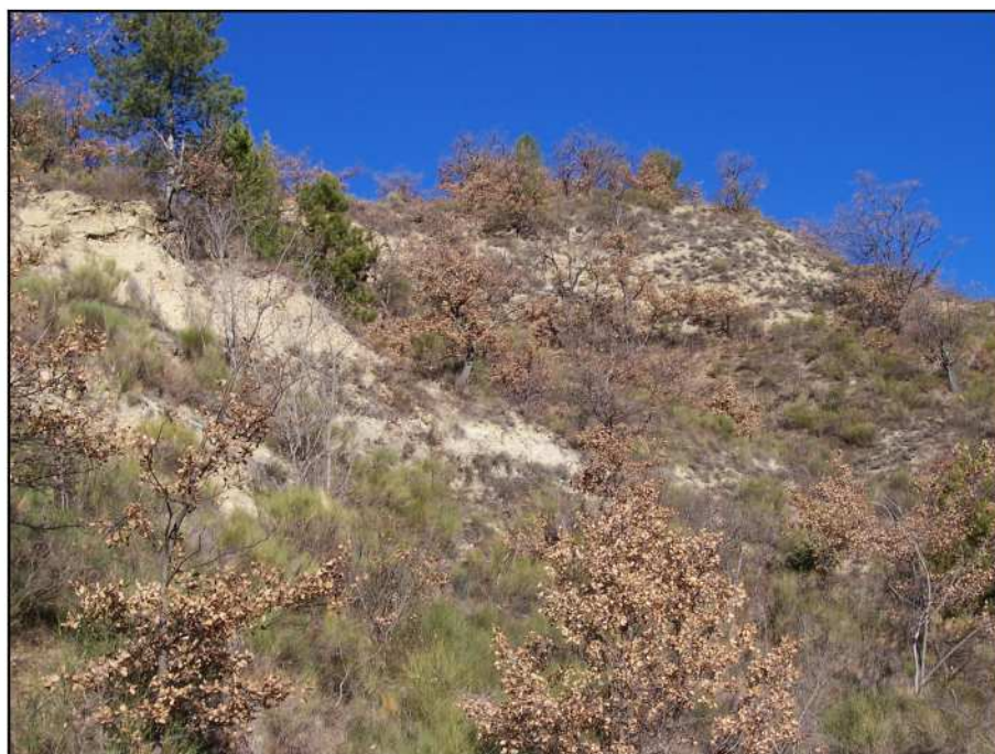
Photo 13: Versant des Baumes, sujet aux glissements de terrain et aux phénomènes érosifs.
