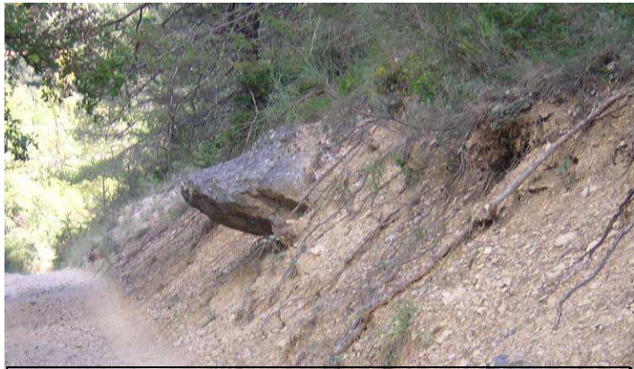
Fig.22: Anciens blocs éboulés
