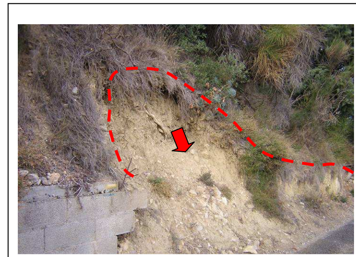
Fig.34: Petit arrachement au sein de colluvions
